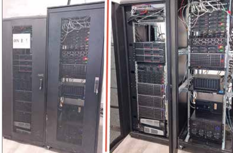
Εξοπλισμός του n-NET για την υποστήριξη των δικτύων 5ης γενιάς.
